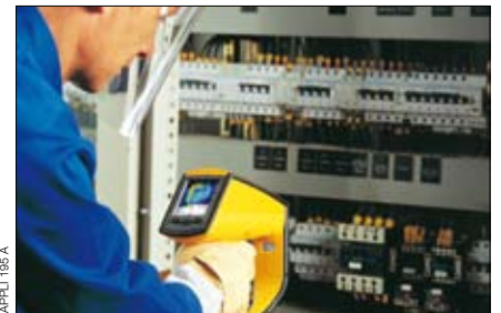
Inspección del panel de distribución
