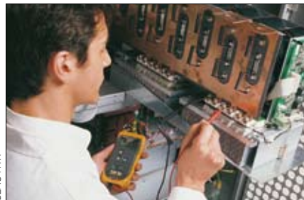
Inspección del SAI
